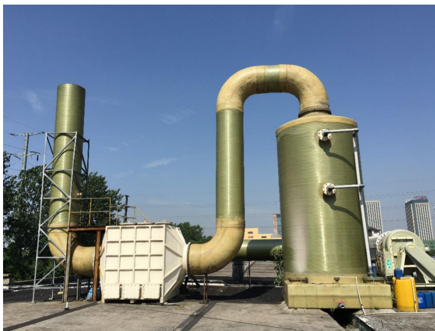
图 4.1-2 喷漆废气处理系统照片
